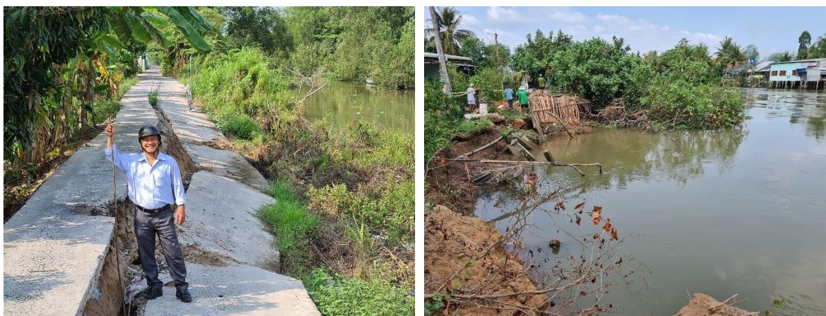
Hình 4: Sạt lở đất tại xã Tân Bình, huyện Bình Tân – tháng 3/2021 (nguồn: Ban chỉ huy PCTT&TKCN tỉnh Vĩnh Long).
